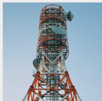
参考 長野県塩尻市 東京電力本所 塩尻送電所
